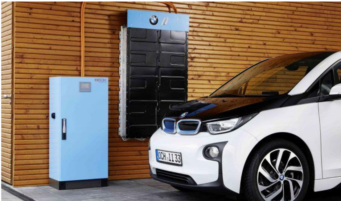
ภาพที่ 3-4 Stationary Energy Storage System ที่ใช้แบตเตอรี่จากรถยนต์ BMW i3
